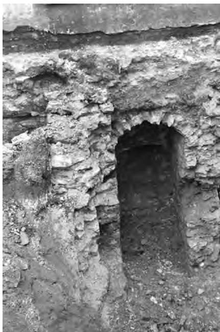
Fot. 6. Chełm, ul. Przechodnia. Część południowa piwnicy. Wnęka po badaniach i odtworzeniu pierwotnej funkcji przejścia. Fot. S. Gołub
