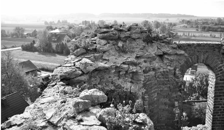
Fot. 4. Stołpie. Widok zniszczonej korony muru północno-wschodniego, z postępującą degradacją – 2018 rok (fot. S. Gołub)
