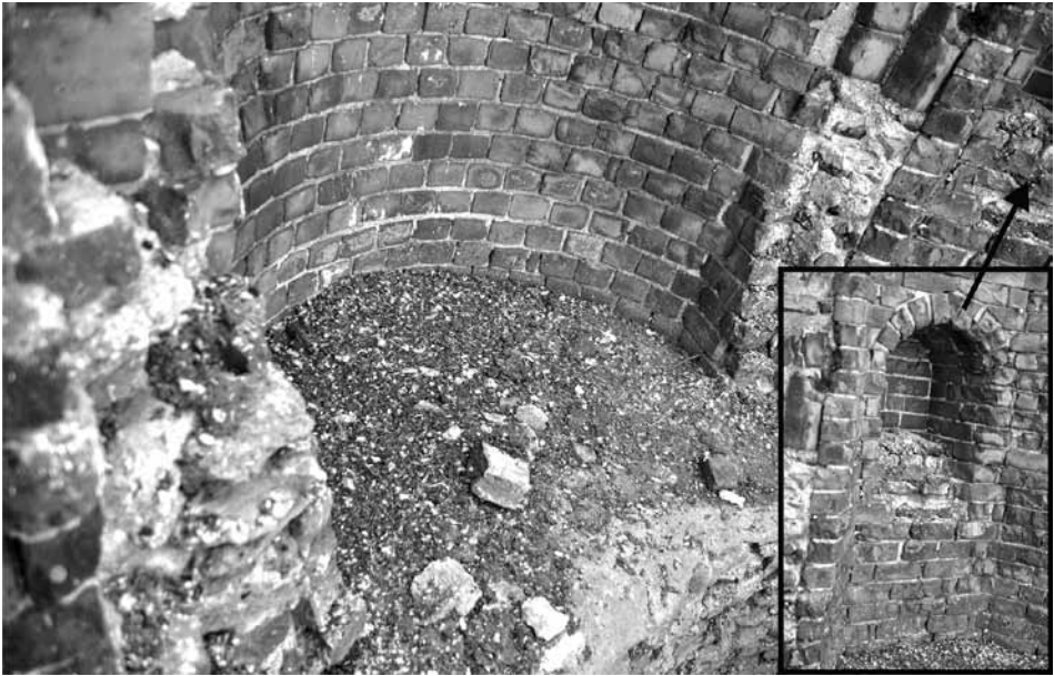
Fot. 5. Stołpie. Zniszczona odchodami ptasimi górna kondygnacja wieży z unikatową kaplicą – 2018 rok (fot. S. Gołub)
