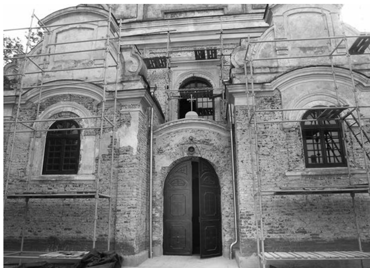
Fot. 4. Wymiana tynków na przybudówkach w elewacji frontowej Fot. S. Rudnik, 2012 r.
