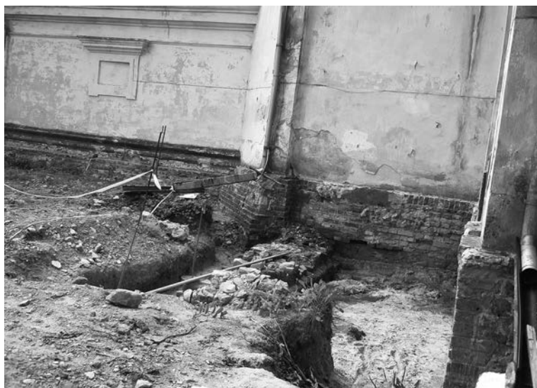
Fot. 2. Prace przy izolacji fundamentów kościoła Widoczny fragment muru budowli przylegającej do kościoła od strony płn.-wsch. Fot. B. Kruk, 2011 r.
