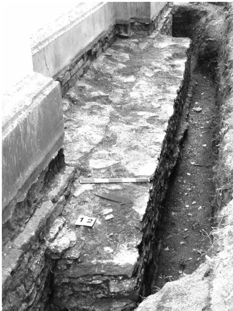
Ryc. 3. Chełm, ul. Sienkiewicza 1. Cerkiew pw. św. Jana Teologa. Wzmocnienie fundamentu w części centralnej północnej ściany świątyni. Widok od wschodu (fot. A. Bronicki)
