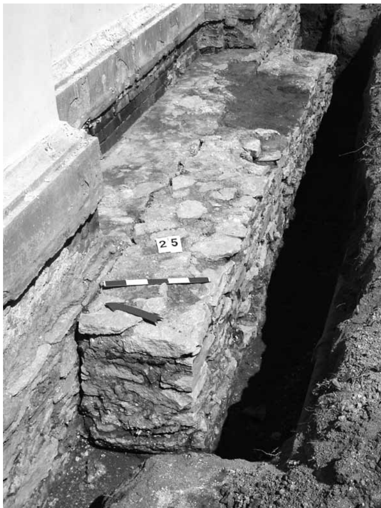
Ryc. 5. Chełm, ul. Sienkiewicza 1. Cerkiew pw. św. Jana Teologa. Wzmocnienie fundamentu w części centralnej południowej ściany świątyni. Widok od zachodu (fot. A. Bronicki)
