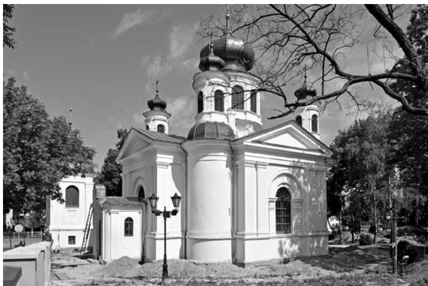
Ryc. 1. Chełm, ul. Sienkiewicza 1. Cerkiew pw. św. Jana Teologa podczas prac remontowych w sierpniu i wrześniu 2013 r. Widok od południowego zachodu (fot. G. Zabłocki)
